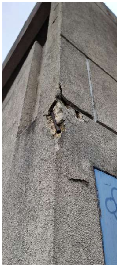
Fig 24. Éclatement du béton en façade Avril 2024 Nathan CURSOUX
