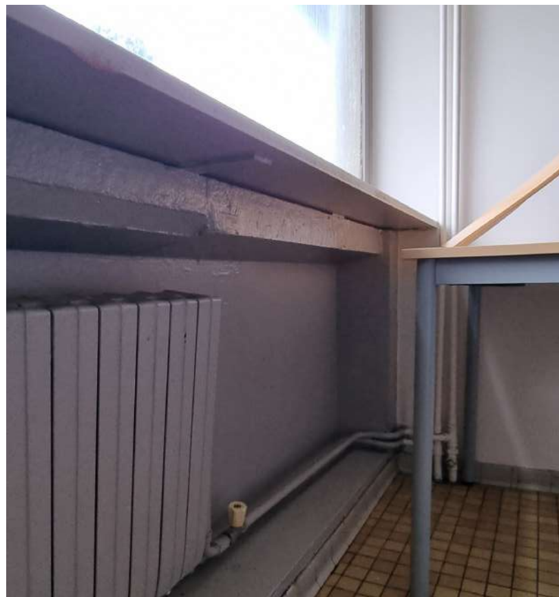
Fig 27. Isolation inexistante contre l'allège de la fenêtre des chambres Janvier 2024 Nathan CURSOUX
