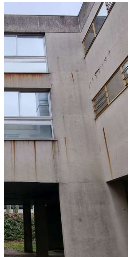
Fig 25. Corrosion et apparition du plancher en façade Décembre 2023 Nathan CURSOUX
