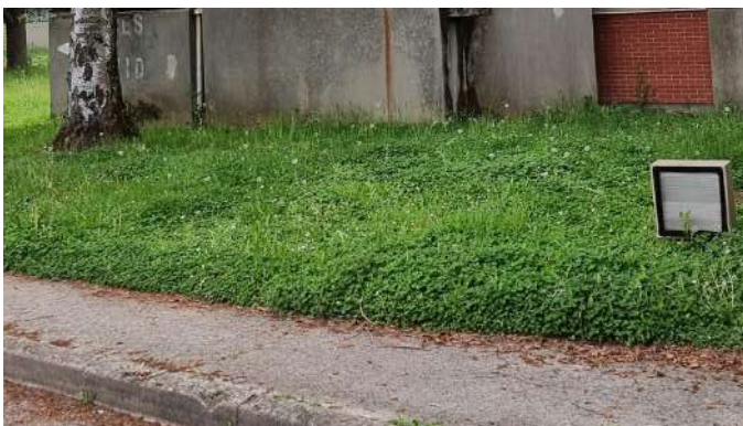
Projecteurs au sol
